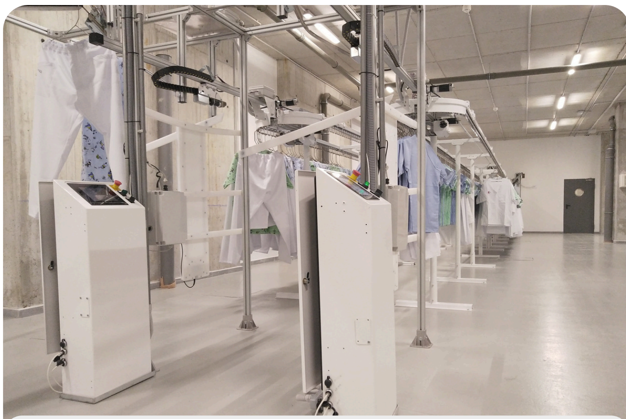
Dispensador automático de ropa en Hospital Valdecilla
